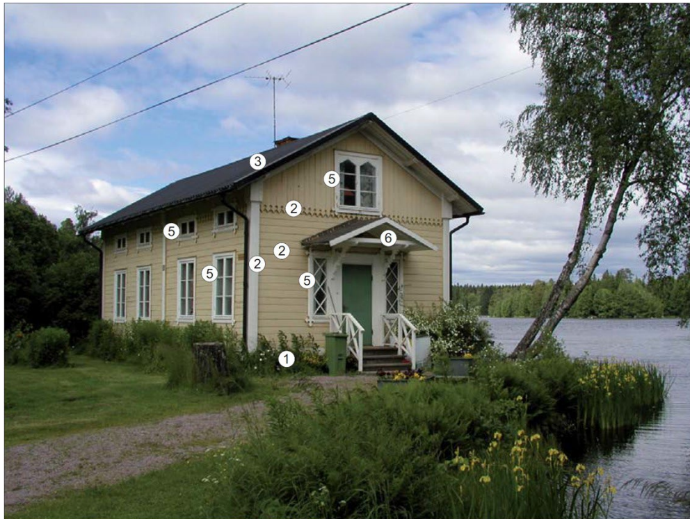
Befintlig byggnad vid Kerstin Hesselgren väg. Källa: Bebyggelse i Hofors – en byggnadsinventering (2007)
